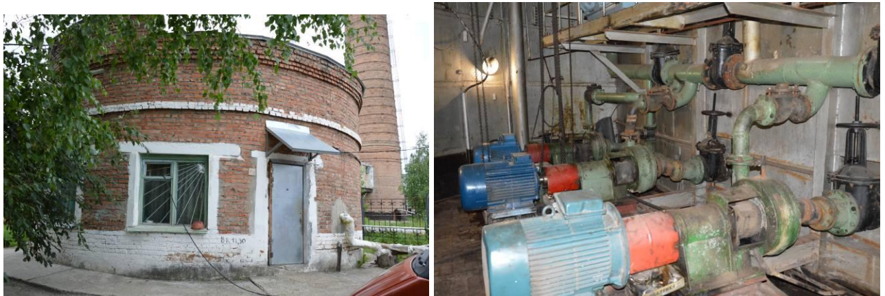
Рисунок 8 – Общий вид КНС-6/74 (слева), машинный зал КНС-6/74 (справа)
