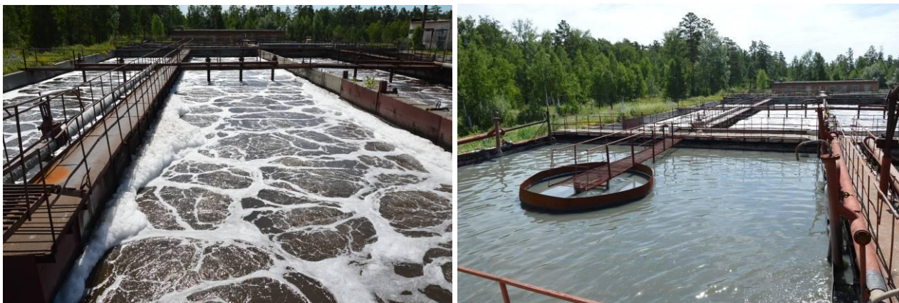
Рисунок 3 – Аэротенки (слева) и первичные отстойники (справа) на канализационных очистных сооружениях
