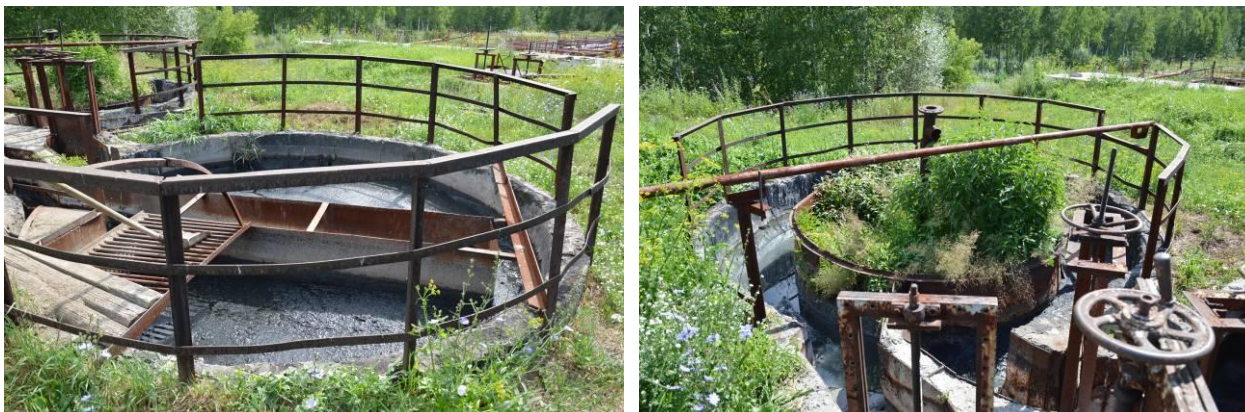
Рисунок 2 – Тангенциальные песколовки на канализационных очистных сооружениях
