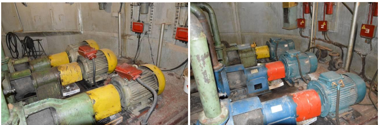
Рисунок 9 – Машинный зал КНС-10/41 (слева), машинный зал КНС-6/106 (справа)
