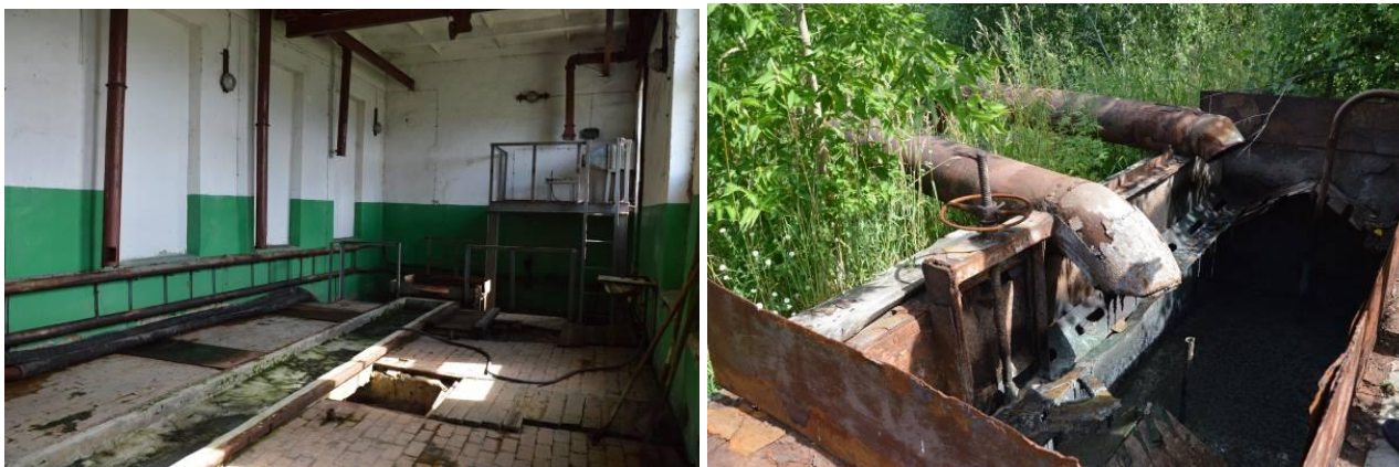
Рисунок 1 – Мазутоловушки и решетки (слева), приемная камера (справа) канализационных очистных сооружений
