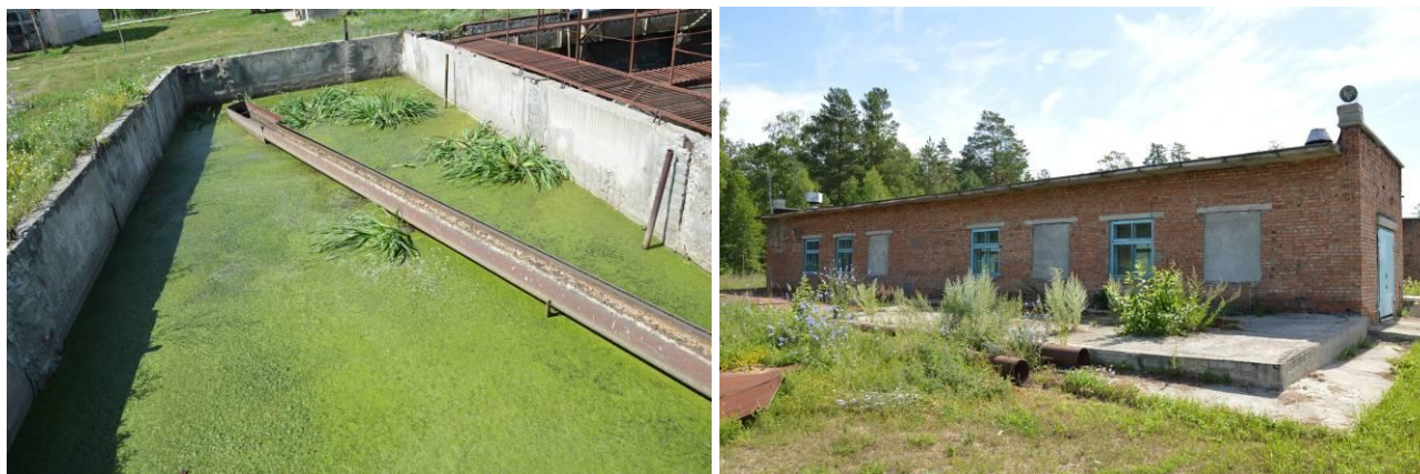
Рисунок 5 – Контактный резервуар (слева) и станция доочистки сточных вод (справа) на канализационных очистных сооружениях
