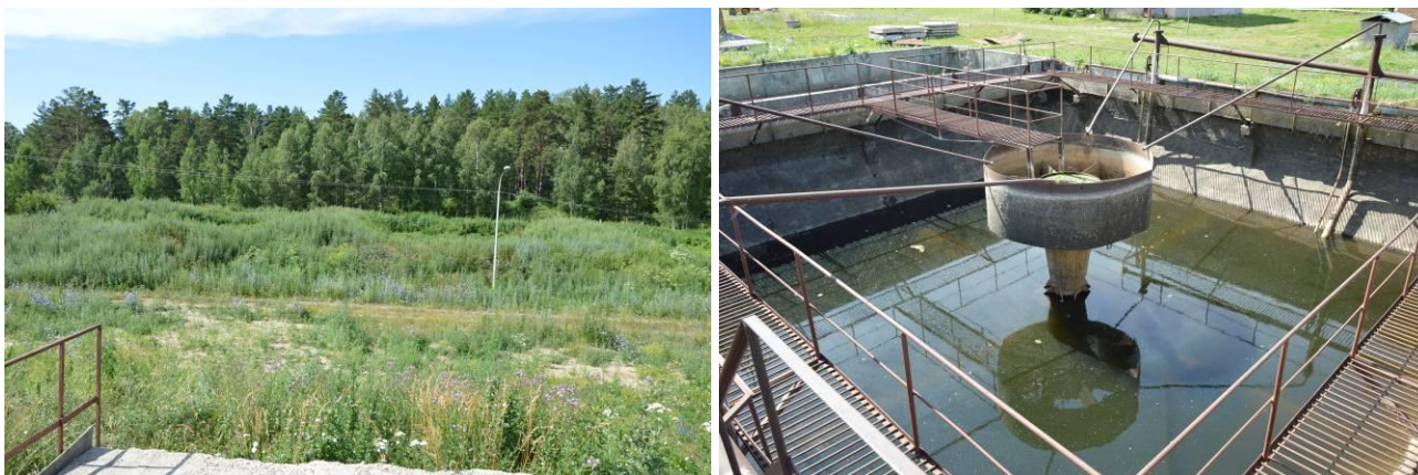
Рисунок 4 – Иловые площадки (слева) и вторичный отстойник (справа) на канализационных очистных сооружениях
